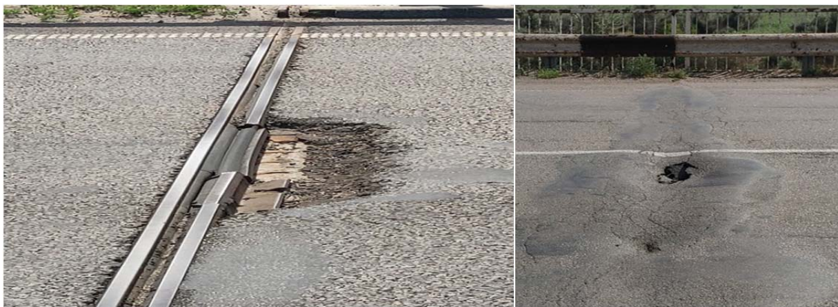
Рисунок 1 – Дефекти асфальтобетонного покриття в зоні деформаційних швів мостів Джерело: розроблено автором
