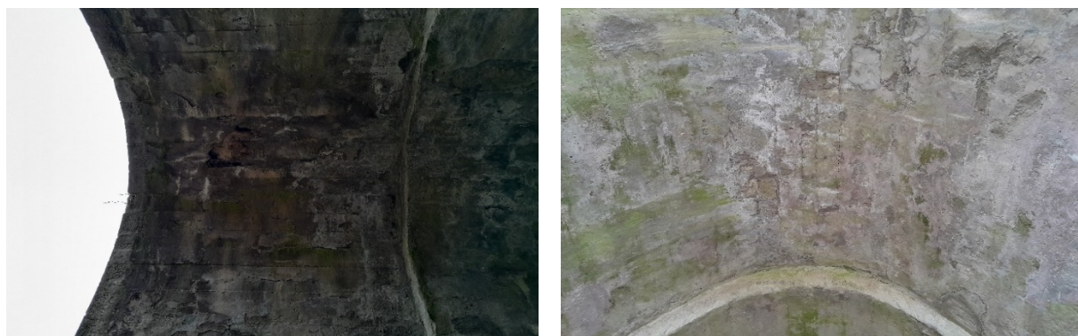
Рисунок 3 — Ланка 1 - 2 Сліди вилугування бетону. Пошкодження бетону від вилугування, раковини бетону
